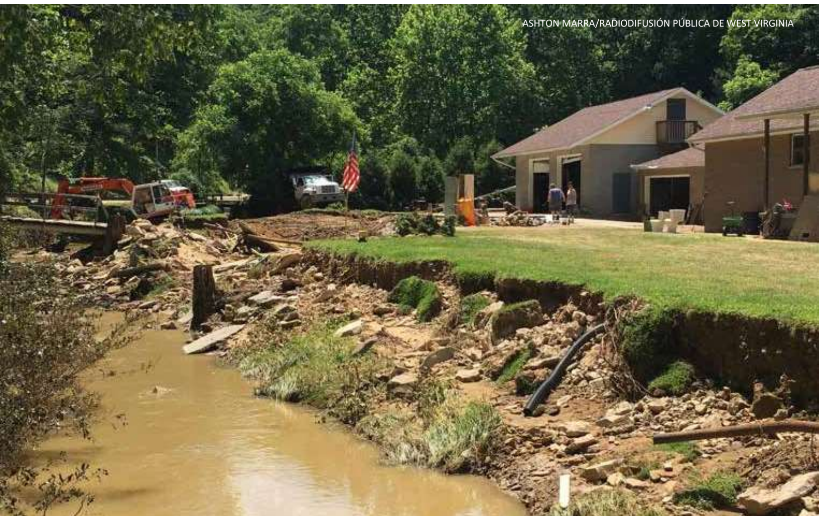
Imagen 25: Una retroexcavadora, izq. trata de reconstruir el terreno donde solía haber un puente privado. El puente fue arrastrado por las aguas de la inundación.
