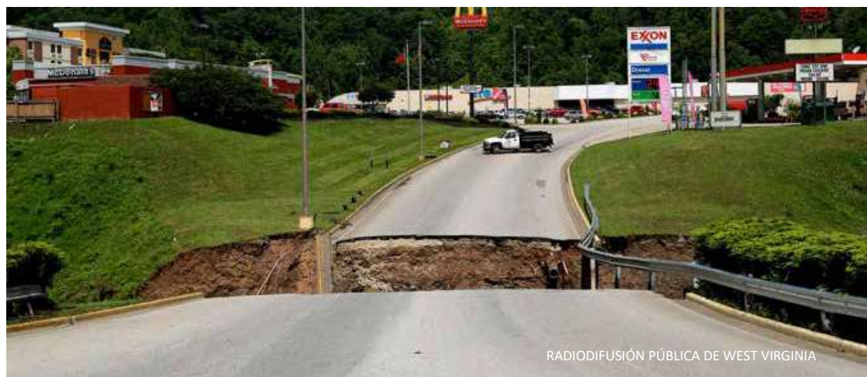
Imagen 20: Puente colapsado en Crossing Mall, Elkview
