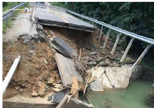
Imagen 15: La ruta 4 cerca de las fronteras del condado de Kanawha y Clay arrasada durante las inundaciones
