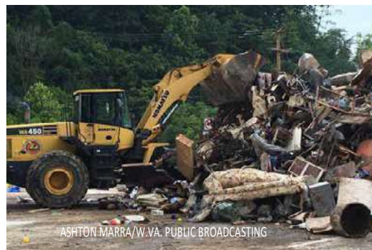
Imagen 19: Se eliminan escombros de la inundación en la salida Clendenin de la Interestatal I-79.
